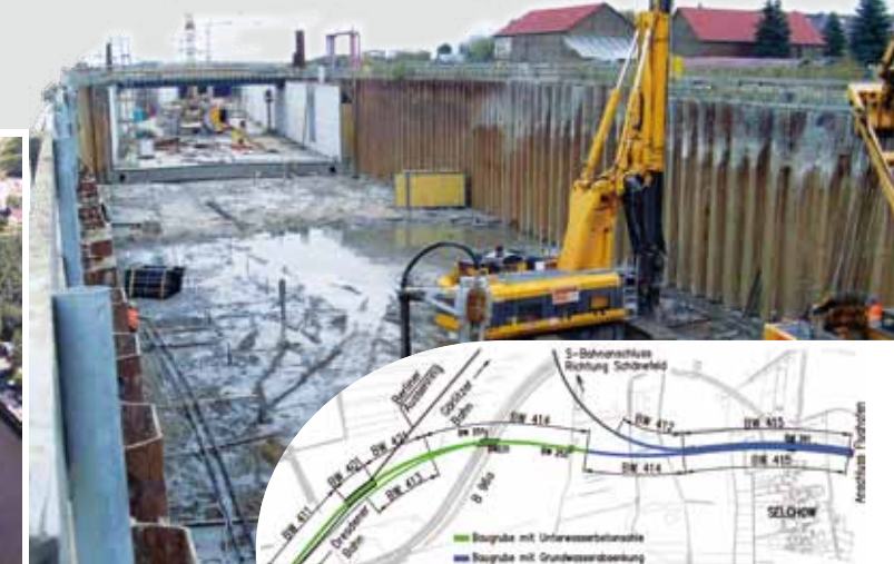
Flughafen BBI, Berlin-Brandenburg Baugrubenplanung der westlichen zweigleisigen Schienenanbindung – Führung der 2,7-km-Strecke vorwiegend als Trogstrecke sowie im Terminalbereich unterirdisch (LP 3-5)
